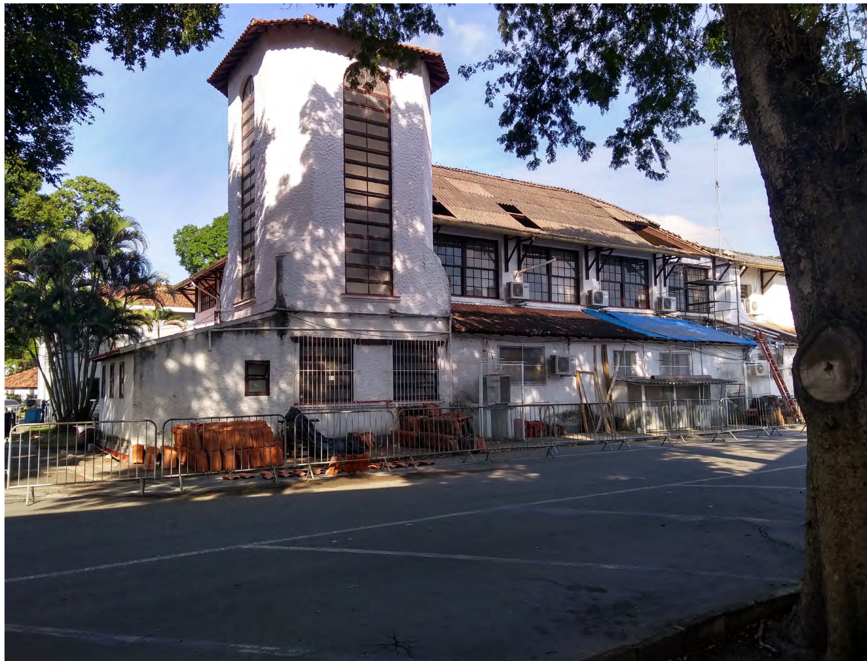
Foto: Registro da reforma e remodelação do telhado da Biblioteca em 2019. A torre não sofreu alterações, continua com as janelas e o telhado originais. Acervo: CMel
